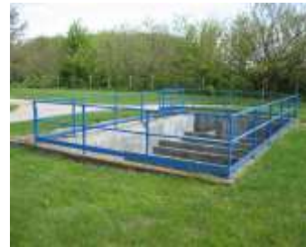
13. ábra: fertőtlenítő műtárgy
